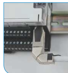
directe aansluiting– gebouwenautomatisering
